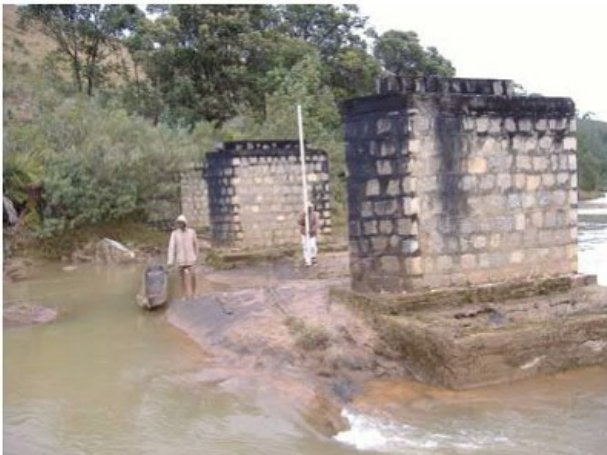
Le pont Tratrambolo tient une importance capitale dans le désenclavement des Communes bénéficiaires qu'elles étaient prêtes à tout faire pour la prise en charge de sa réhabilitation après passage du cyclone.
