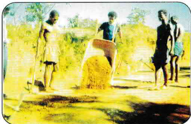
Entretien des pistes: la réparation de la chaussée (nids de poule...) s'effectue généralement juste après la saison des pluies (mois d'Avril).
