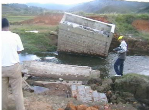
Les infrastructures construites par le projet ACORDS ont aussi subi (Pont coupé sur l'axe Vinanitelo – Sandranata)
