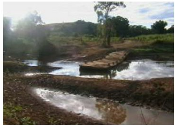
Remblai d'accès emporté sur l'axe Befotaka - Ambaliha
