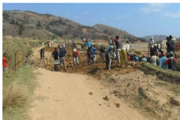
A Amparatanjona, l'encadrement des travaux communautaires est prévu pour l'année 2 mais la commune a sollicité le projet pour traiter une portion de digue rompue, entravant la circulation.
