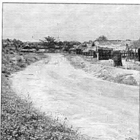
La RN6 victime de malfaçon ou d'inadéquation?
