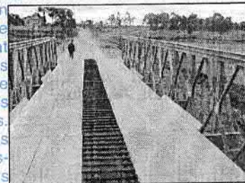
Pont Mabey Johnson installé à Ambohimandroso (RN7 PK 85) après le dynamitage du pont en dur.
