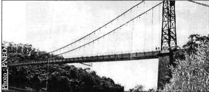
Le pont suspendu d'Anjilajila à Mananjary ( province de Fianarantsoa) au PK 159.80 sur la RN25. Il a été construit en 1933 par la maison Leinekugel le Cocq et fils. Sa longueur est de 193,35 m. Il a coûté 2 750 000 F de l'époque.
