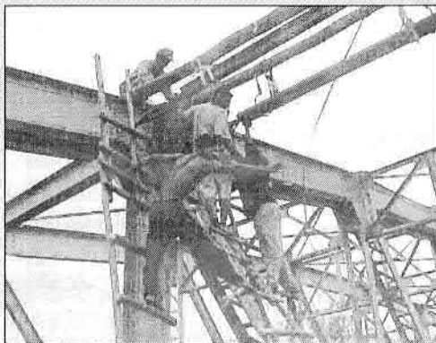
Réparation de la structure du pont à voies mixtes Mangoro sur la RN2 (PK 93) déstabilisé après le passage d'un camion.
